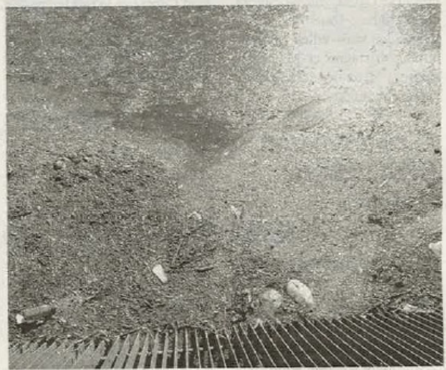
Actuellement, une grille empêche les déchets de tomber dans la turbine.
